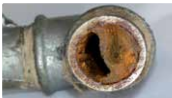
Potrubí s usazeným vodním kamenem
