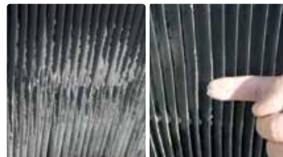
Mřížka chladicí věže
